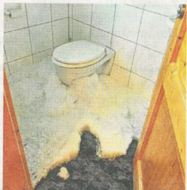
Durch die Toilette drückte es Hagelkörner in die Wohnung.
