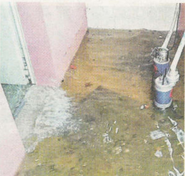
Das Wasser wurde aus Wohnungen und Kellern gepumpt.
